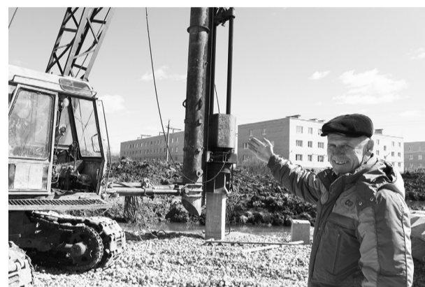
Заместитель руководителя подрядной организации ООО «Деметра» Леонид Молошнев регулирует процесс забивания свай
